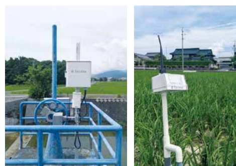
水田管理システム設置の様子
